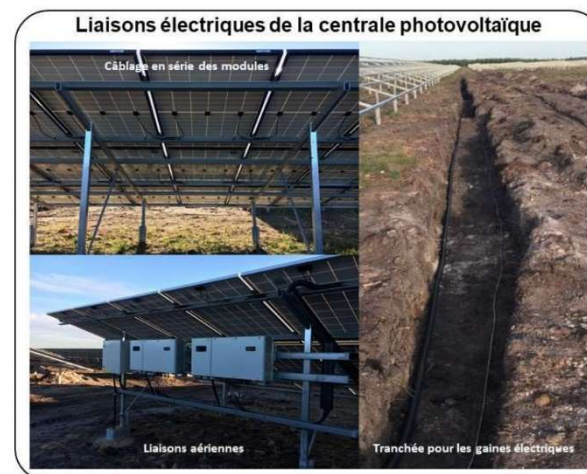
Photographie 5 : Liaisons électriques
