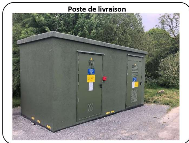
Photographie 3 : Poste de livraison de teinte vert foncé (RAL 6003)
