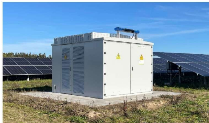
Photographie 2 : Poste de transformation
