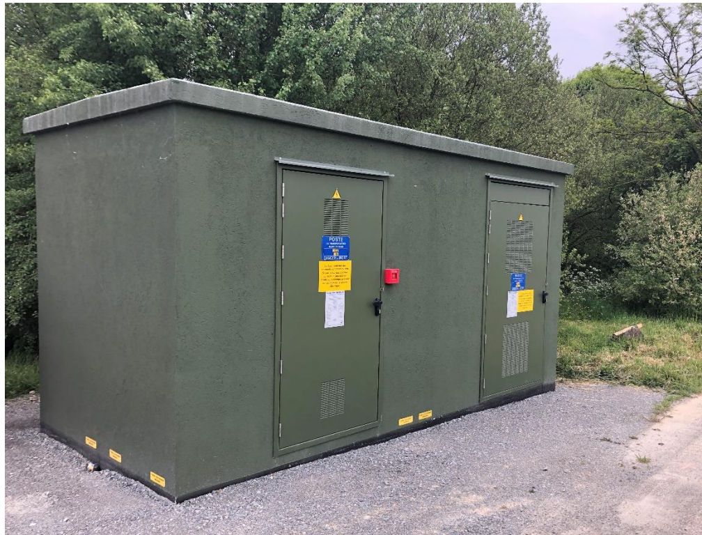
Figure 21 : Poste de livraison
