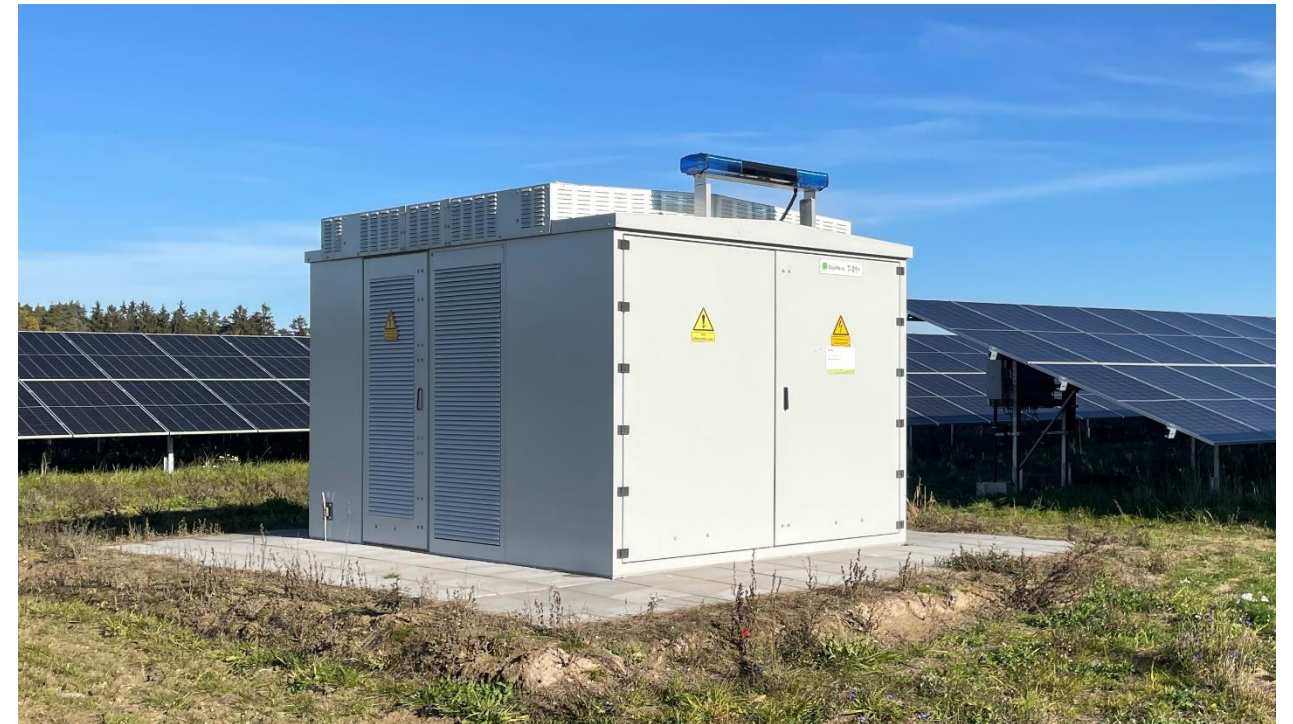
Figure 20 : Poste de transformation
