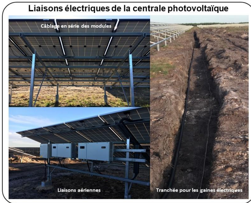
Figure 20 : Liaisons électriques (Source : BayWa r.e.)
