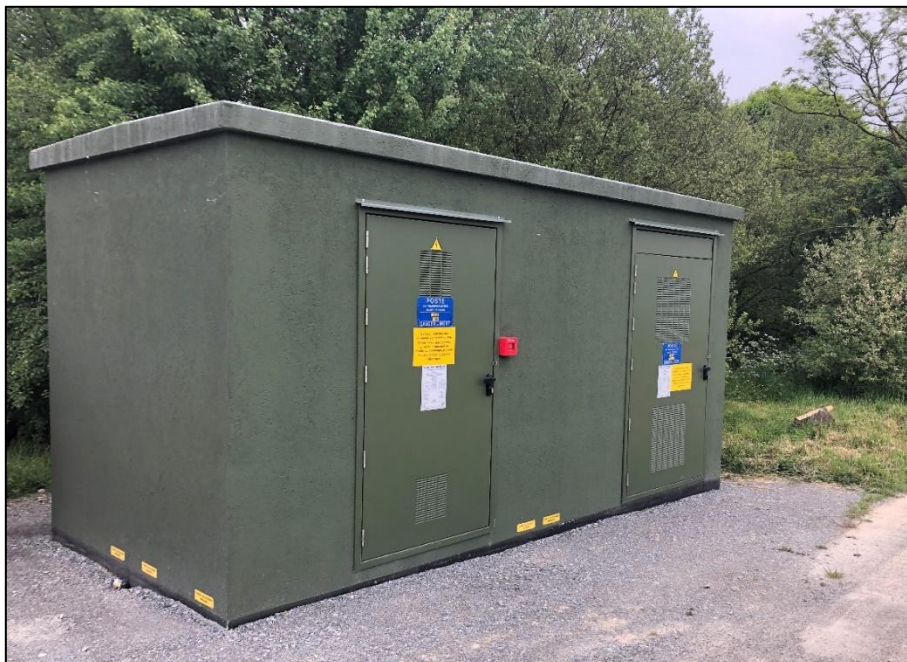
Figure 23 : Poste de livraison de teinte vert foncé (RAL 6003)
