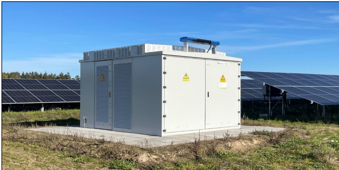
Figure 22 : Poste de transformation (Source : BayWa r.e.)
