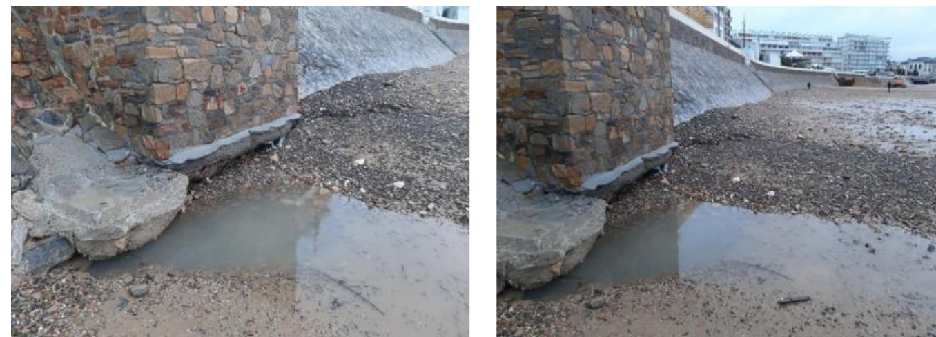
Figure 50 : Affouillement à l'extrémité Ouest du perré de la promenade Wilson (01/2025)
