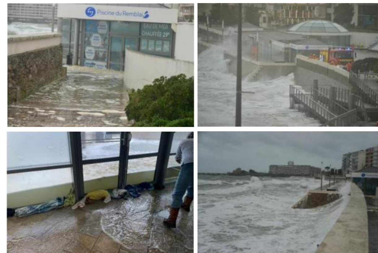
Figure 25 : Désordres constatés lors des épisodes de tempête d'octobre et novembre 2023 au droit du remblai de la piscine
