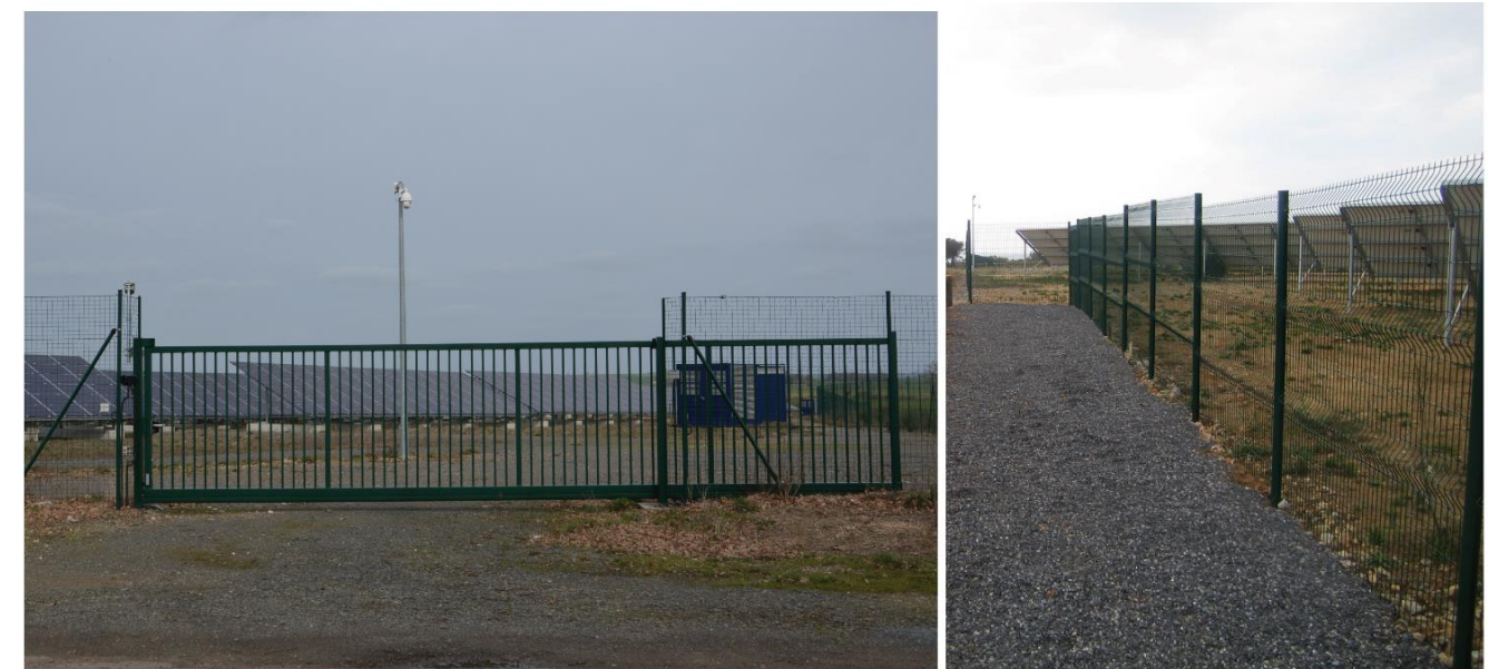
Photographie 7 : Clôture de sécurité et portail d'accès (Source : ENCIS Environnement)
