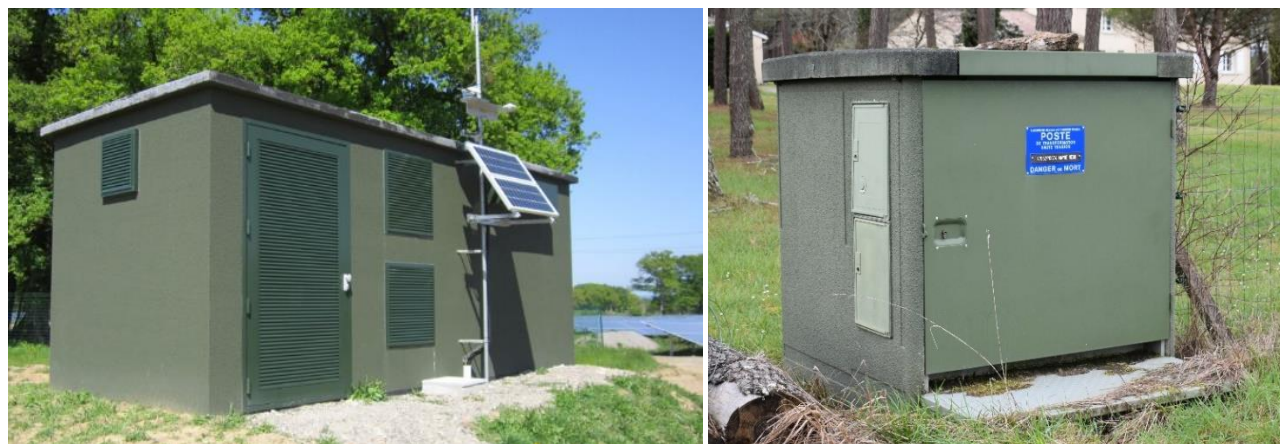
Photographie 4 : Intégration paysagère d'un poste de livraison (Source : ENCIS Environnement)
