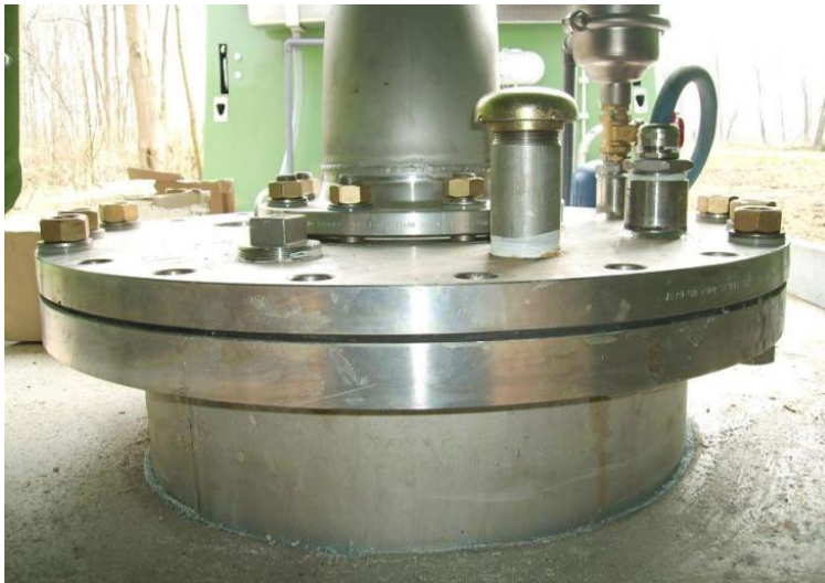
Tête de puits équipée pour l'exploitation
