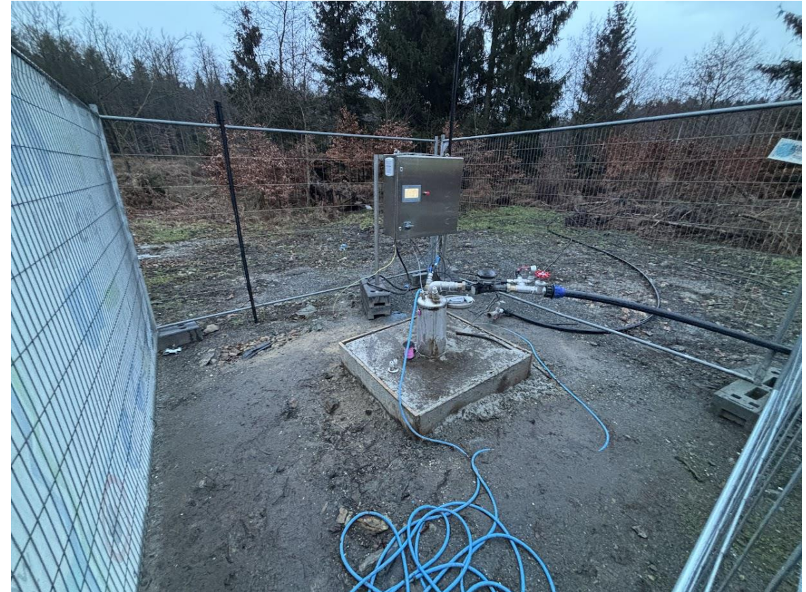
Puits en cours équipé en cours d'essais de pompage
