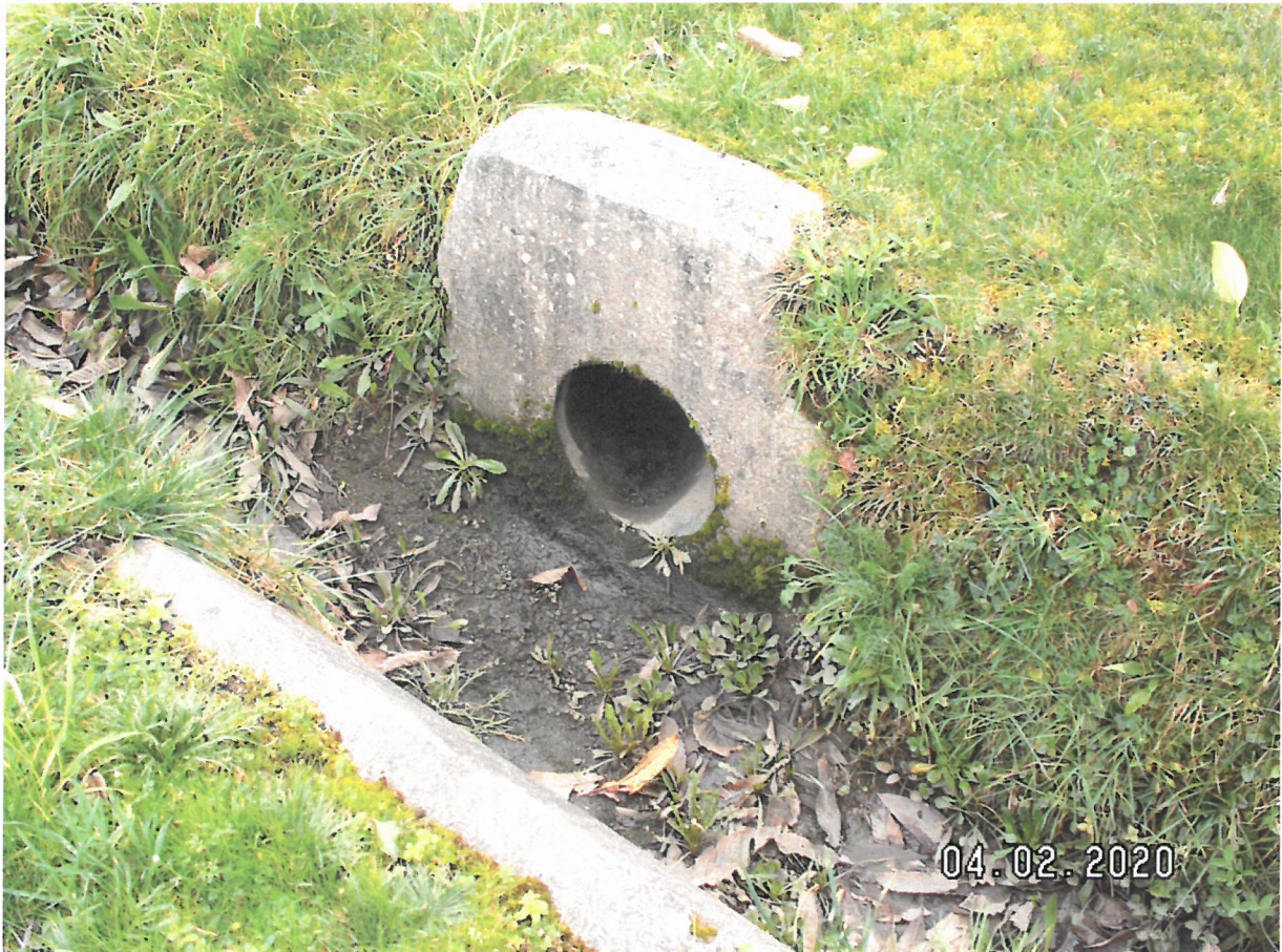
Buse d'aménée, depuis le fossé routier, au "puisard-avaloir" d'infiltration des eaux pluviales.
