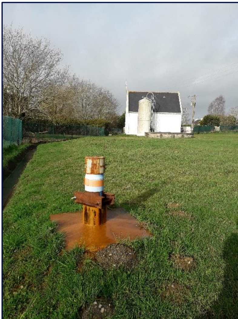
Figure 4 : Photographie du forage CF3-FE3 avec citerneau de protection
