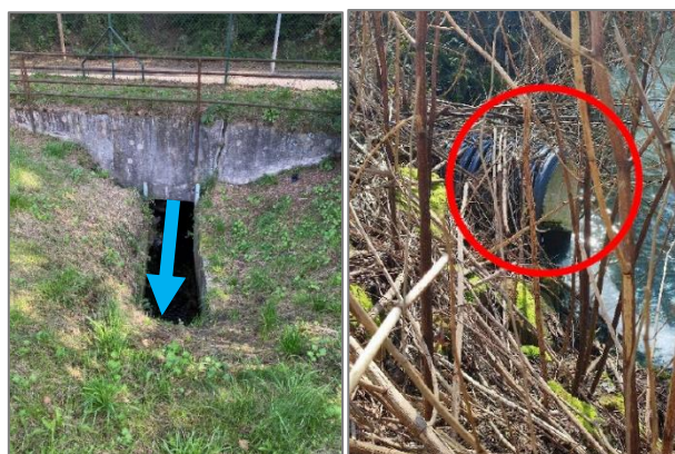
Figure 16 : Ouvrages hydrauliques du Bruchgraben vue sur site par SAGE Environnement en 2024 et par GUELLE et FUCHS en 2024
