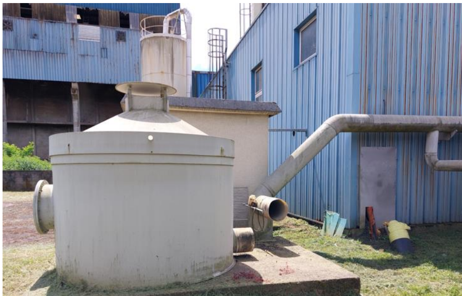
Figure 4 : Installation de désodorisation à l'arrêt
