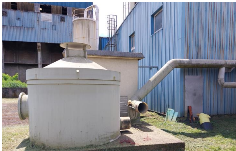
Figure 10: Installation de désodorisation à l'arrêt
