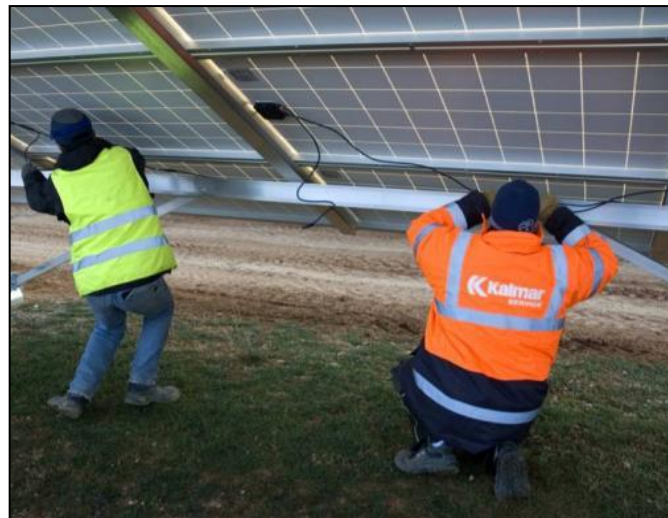
Photo 2 : Câblage intégré aux structures (Ferme Solaire de Bruz/Pont-Péan, une réalisation IEL)
