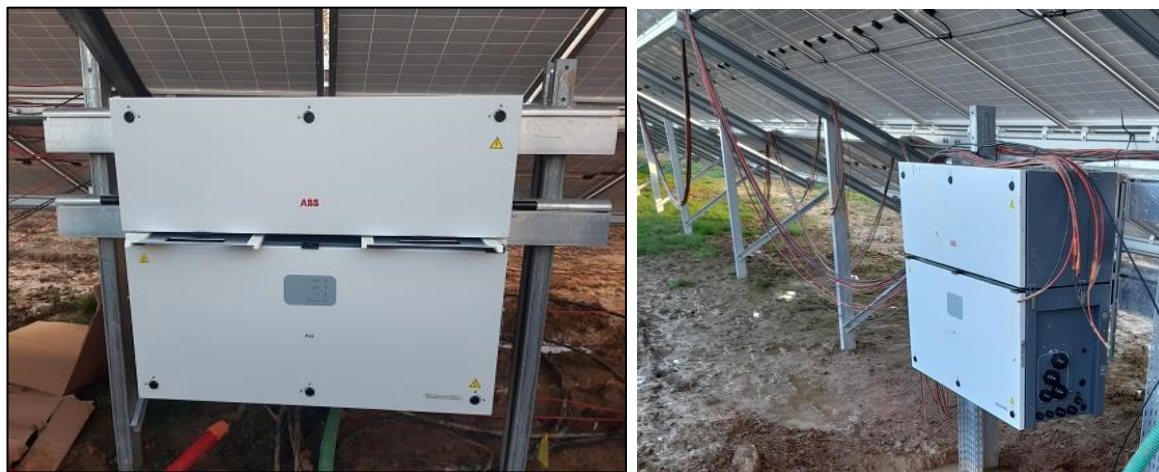
Photo 4 : Onduleurs fixés sur les structures photovoltaïques (Ferme Solaire de Beauvoir, photos prises en phase construction, IEL)
