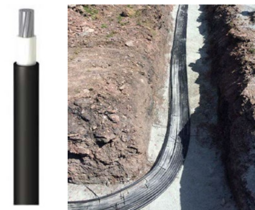
Figure 33. Câble de liaison boîte-onduleur et tranchée (source : Valeco)
