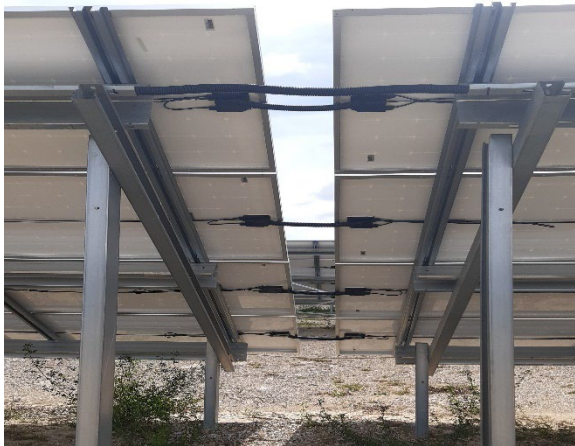
Figure 20 - Câblage sous modules
