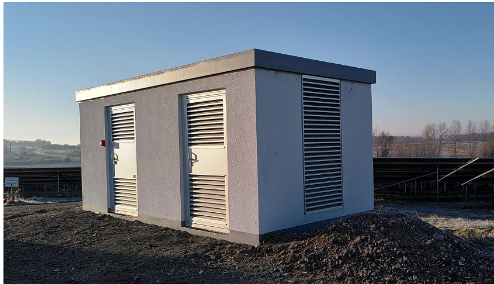
Figure 22 - Poste de transformation remblayé
