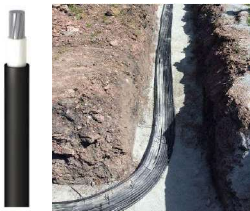
Figure 29 : Câble de liaison boîte-onduleur et tranchée
