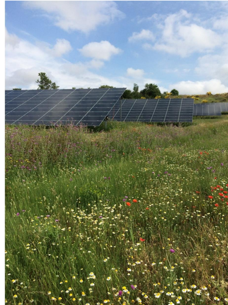
Parc photovoltaïque de Narbonne (source : EDF Renouvelables)
