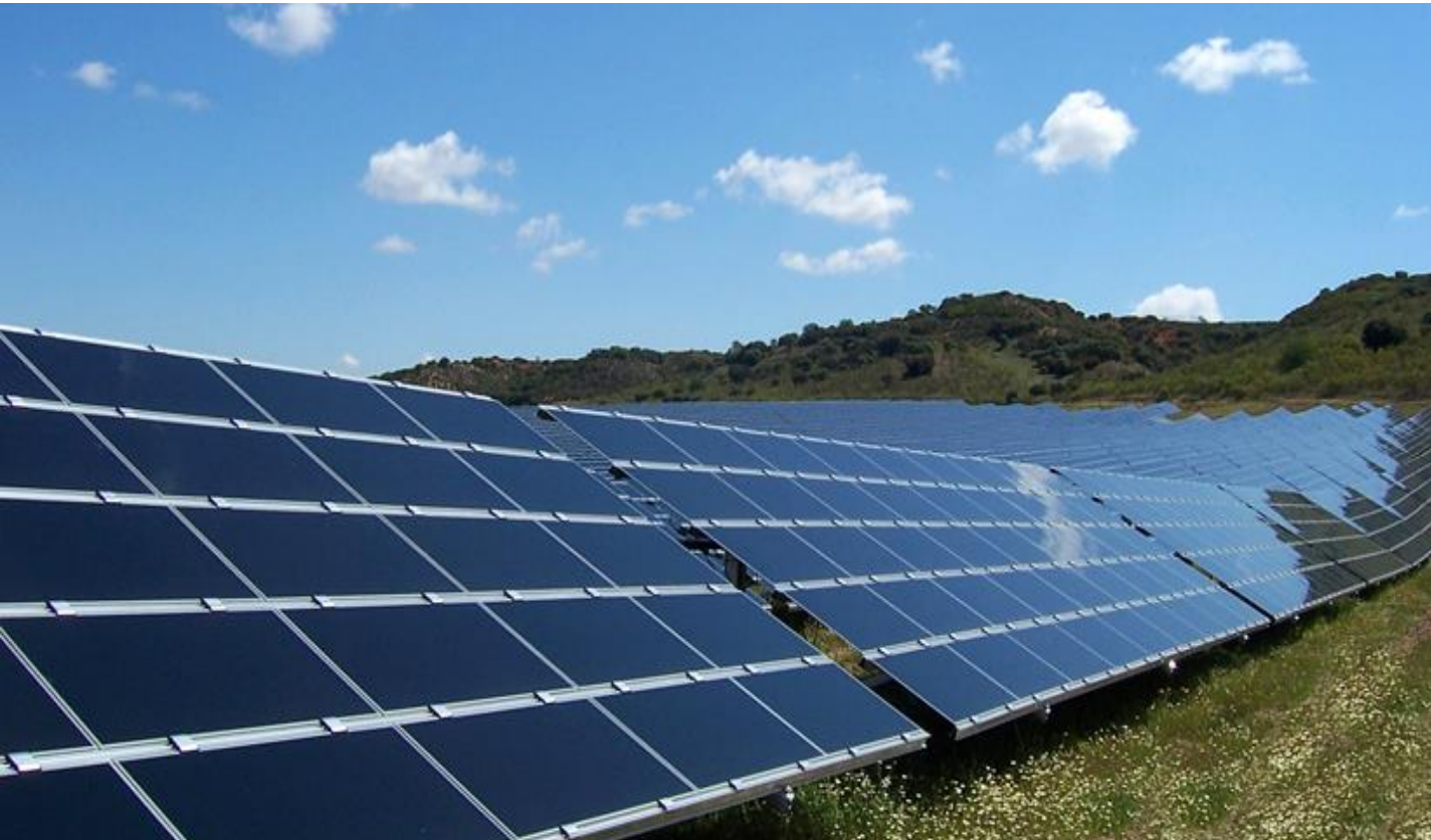
Parc photovoltaïque de Narbonne (source : EDF Renouvelables)
