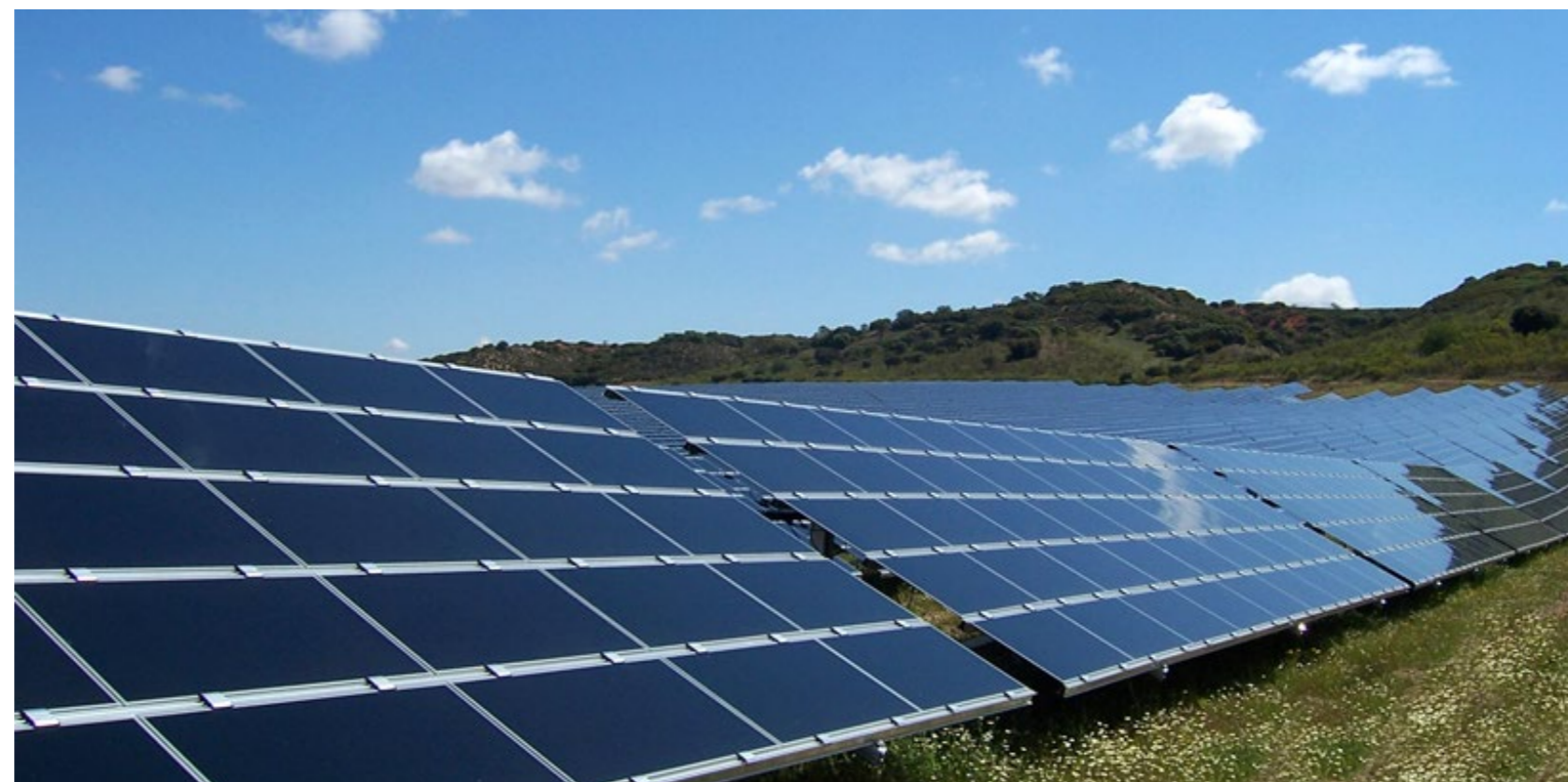
Parc photovoltaïque EDF Renouvelables de Narbonne
