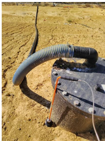
Figure 6 : fuite au niveau du puits C4-A2-4
