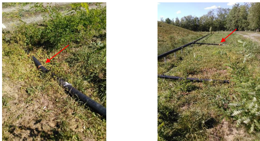
Figure 10 : canalisations endommagées (point C1-N°1)
