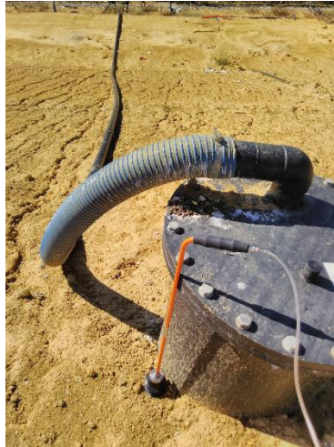
Figure 6 : fuite au niveau du puits C4-A2-4
