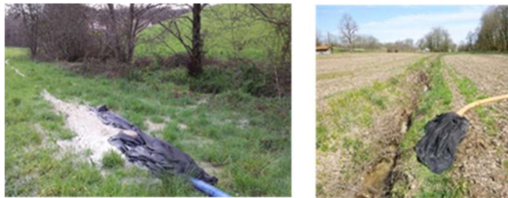
A gauche : rejet dans une « chaussette » en géotextile, orienté de façon parallèle au ruisseau et profitant d'une surface végétalisée, afin de favoriser la filtration naturelle. A droite : rejet aménagé et orienté vers un fossé de drainage afin d'éviter le ruissellement sur la parcelle agricole.
