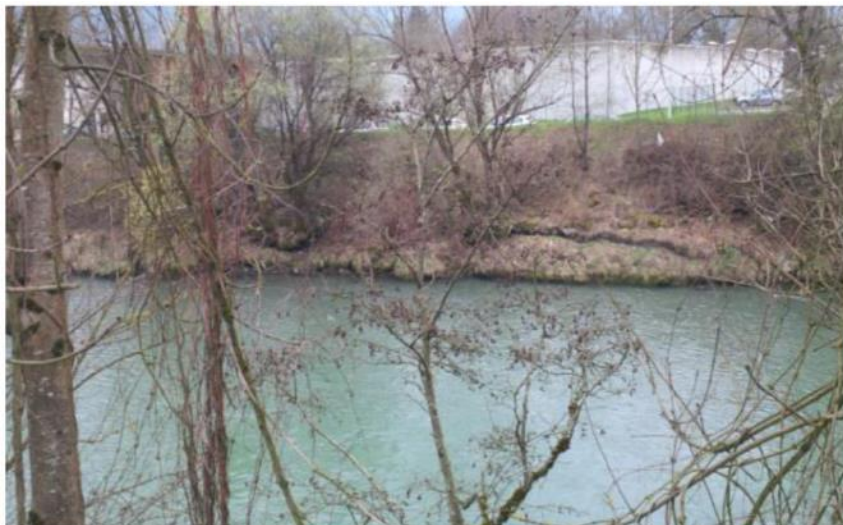
Figure 76 : Merlon de la maison d'arrêt en rive gauche de l'Arve : érosion en pied / affaissement
