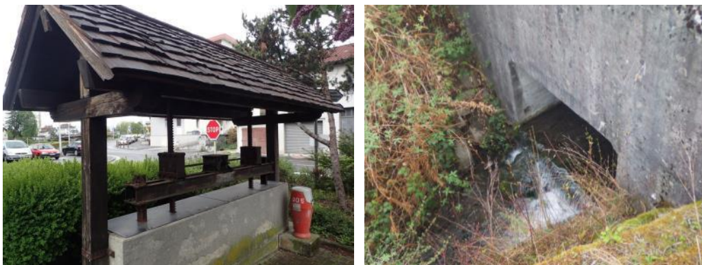
Figure 9 : Vanne de régulation du ruisseau de la Madeleine, et exutoire en rive droite de l'Arve
