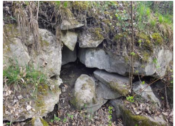
Figure 21 : Bouchet T01 - Phénomène de sous-cavage
