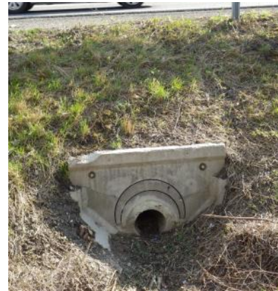
Un exutoire du réseau de drainage
