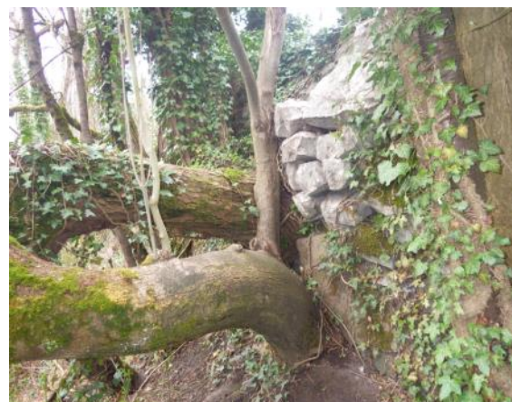
Figure 31 : Trésor Public T01 - Arborescence destructurant le mur en place
