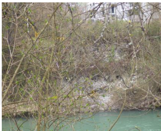
Figure 30 : Trésor Public T01 - Talus érodé sub-vertical
