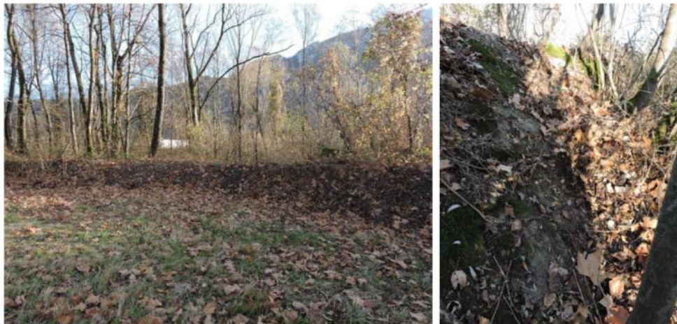
Figure 29 : Photos de la digue du Bouchet T02, partie amont de la vanne Décret
