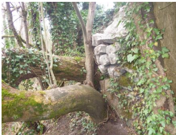
Figure 43 : Trésor Public T01 - Arborescence déstructurant le mur en place
