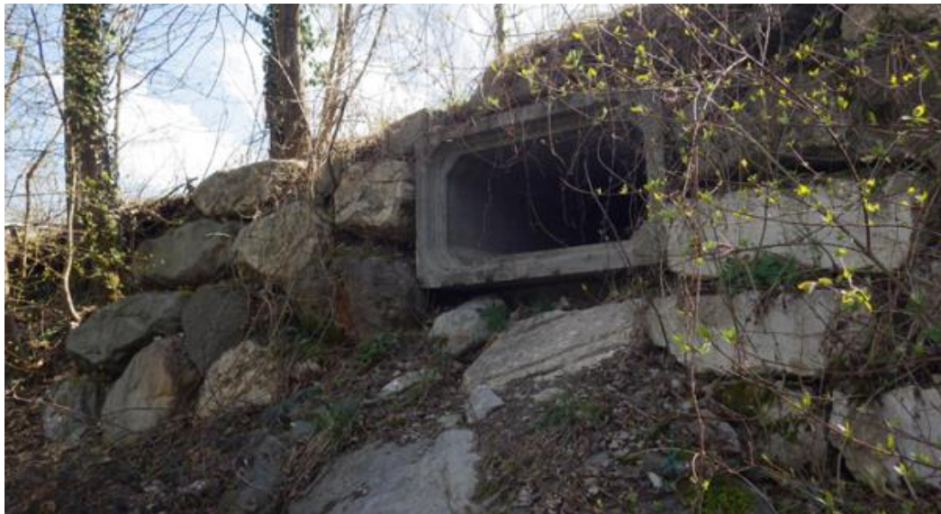
Figure 164 : Castorduc traversant l'ouvrage RD19 (VTA CNR 2017)
