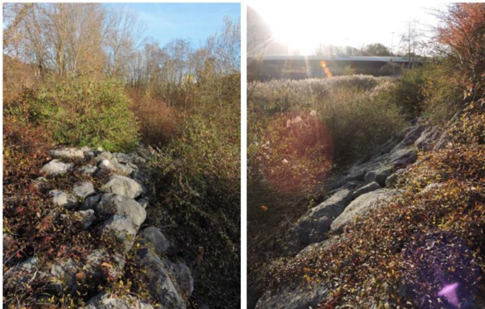
Figure 30 : Photo de la digue du Bouchet T02, partie aval de la vanne Décret
