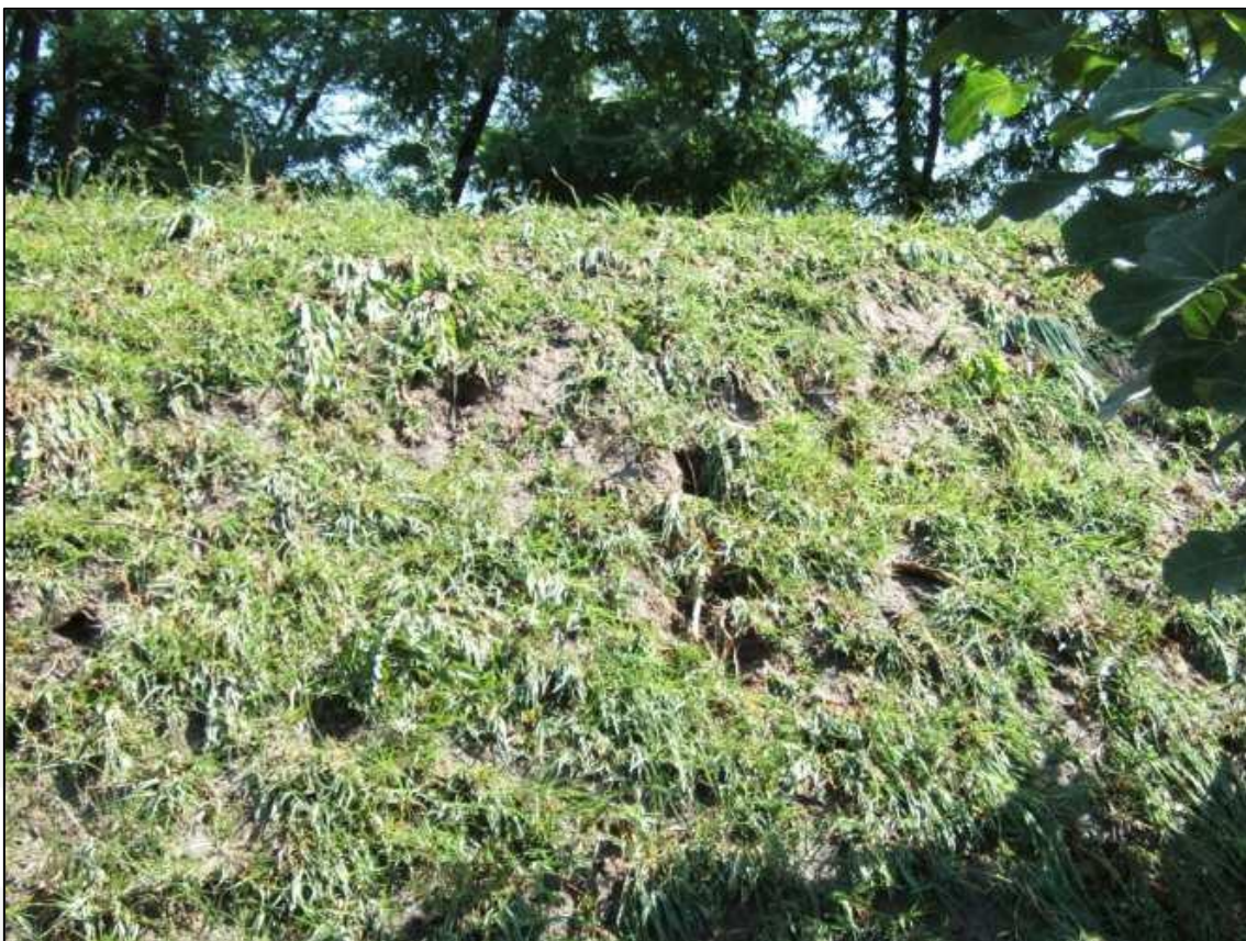
Figure 72 : Début de renard hydraulique RG en amont de la brèche
