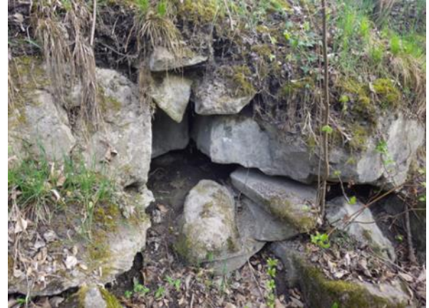
Figure 33 : Bouchet T01 - Phénomène de sous-cavage
