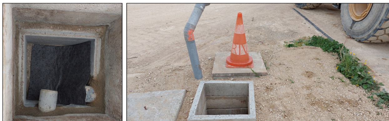
Figure 5 : Exemple de regard aménagé à proximité de l'aire étanche (Point de prélèvement des eaux de rejet- carrière de Charcier)
