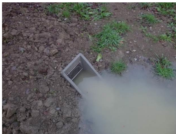
Exemple de trop-plein (Srce: BET LEGRAND)
