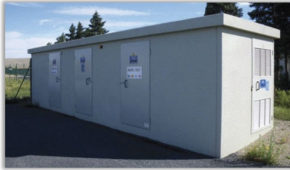
Poste de transformation
