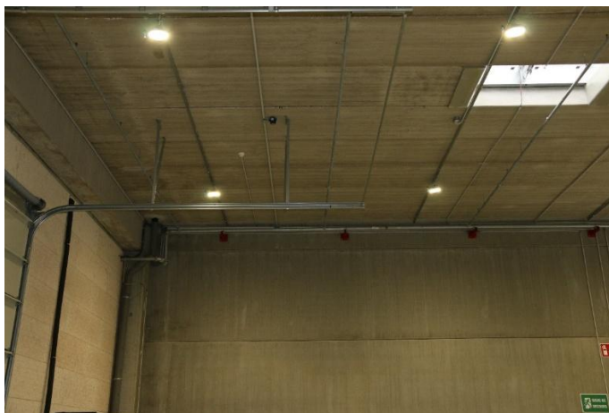
Sprinkler et détection de fuite de gaz. Photographie prise le 18 novembre 2025.
