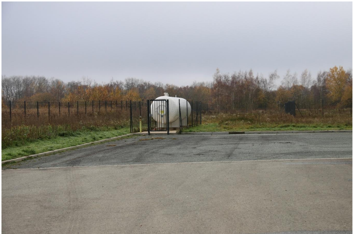
Cuve à hydrogène. Photographie prise le 18 novembre 2025.
