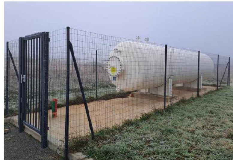
Cuve de stockage de l'hydrogène en extérieur
