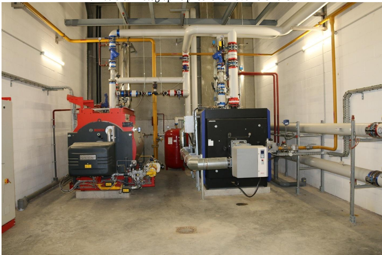
Chaudière au gaz naturel et chaudière hybride (à gauche). Photographie prise le 18 novembre 2025.
