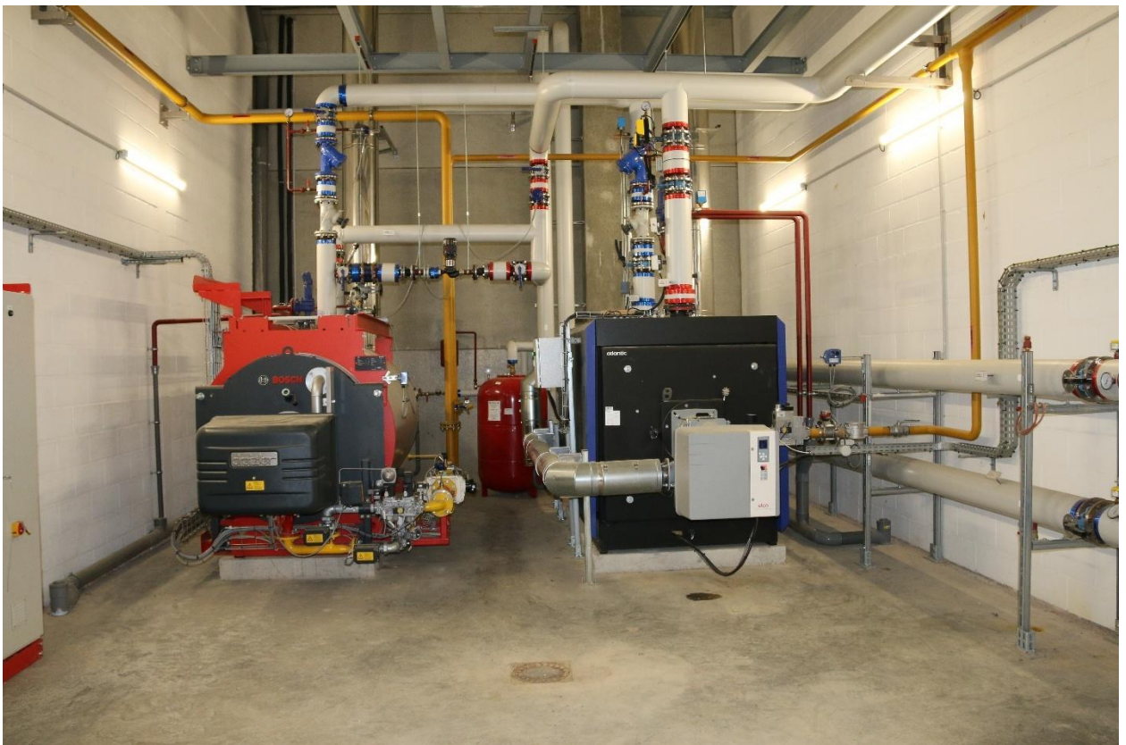
Chaudière hybride (à gauche)
