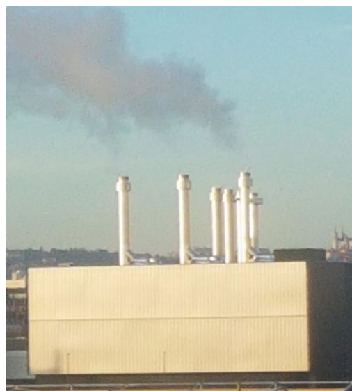
chaufferie bois Surville-Gerland –Sud de Lyon
