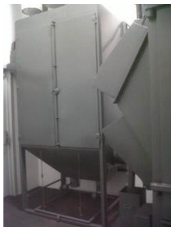
Caisson fermé contenant les filtres à manche
