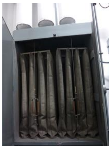
Caisson ouvert avec les filtres à manche
