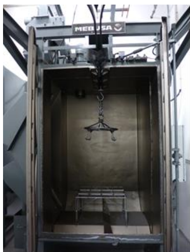
Cabine de sablage
