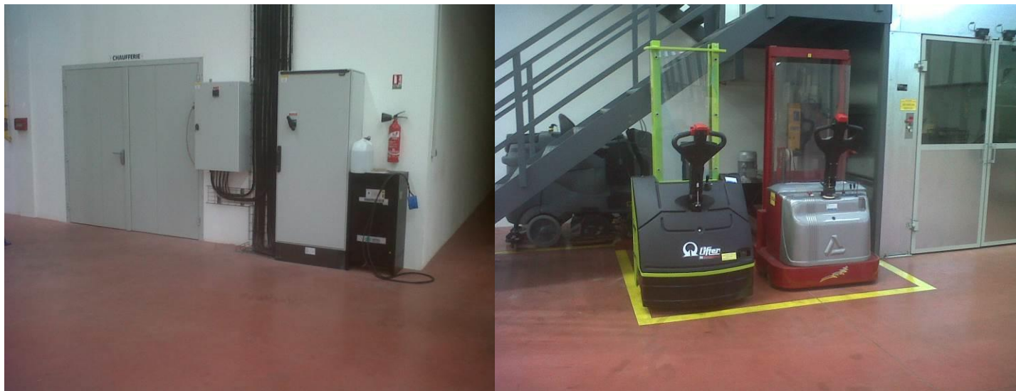
Chargeurs de batterie dans le hall du bâtiment
