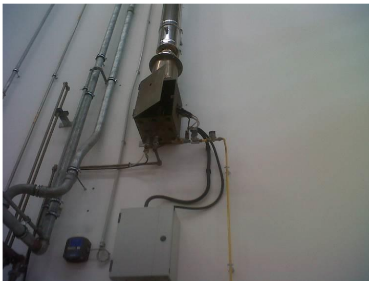
Torchère en sortie du four de nitruration
