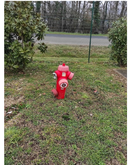
Figure 32 : borne incendie sur le site existant
