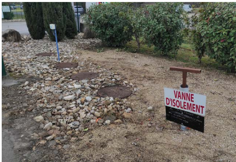
Figure 28 : présence vanne d'isolement au droit du site existant
