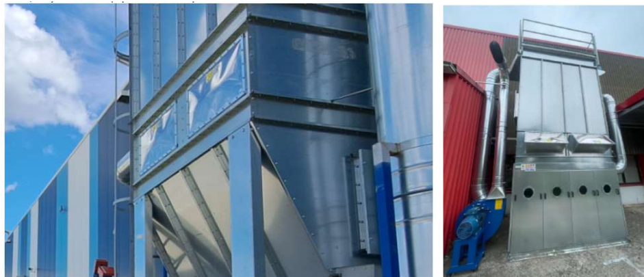
Figure 17 : implantation des événements de décharge de l'explosion de poussières sur cyclone
