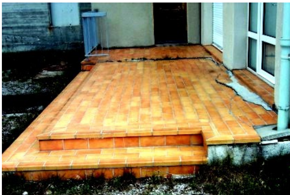
Glissement de terrain aux Ferriers provoquant des fissures dans les bâtiments (hôtel)
