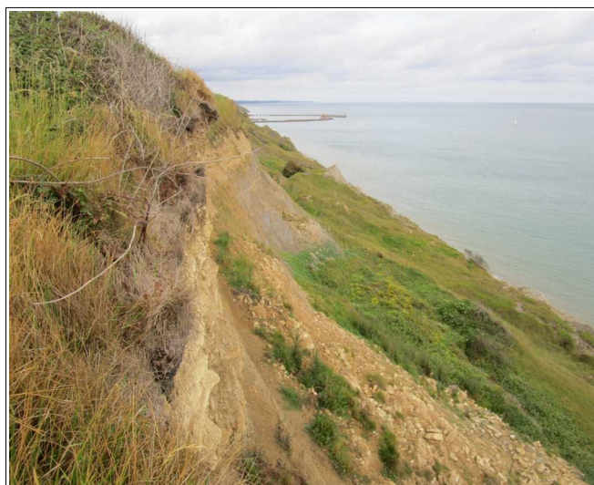
Figure 18: exemple de mouvement de terrain affectant uniquement le ressaut supérieur du versant côtier (près du Mont-Castel).
