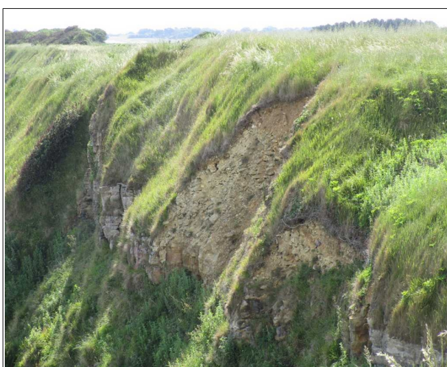
Figure 40: exemple d'affleurement rocheux sommital ; on notera son état très fissuré.
