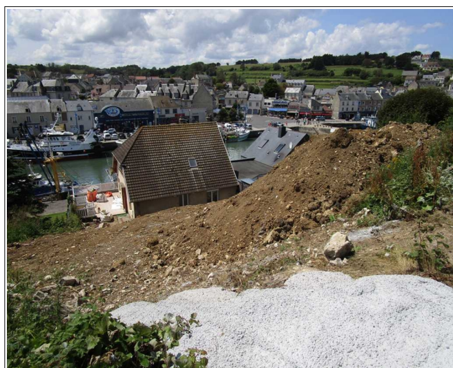
Figure 38: projet de lotissement du versant occidental du Mont-Castel ; on notera les dépôts de terre en bordure aval de la zone de projet.
