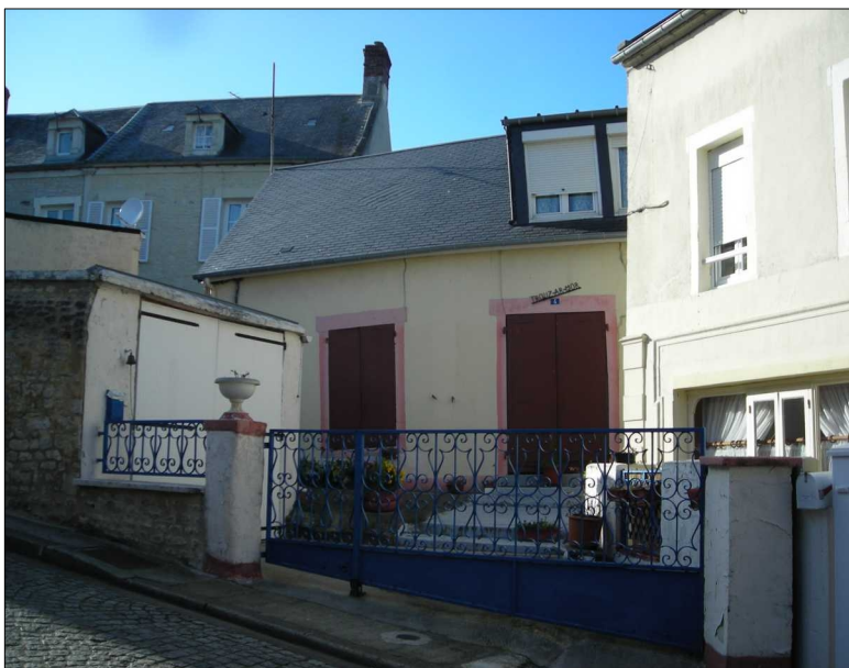
Figure 13: Une maison située au 4, rue du phare présentait d'importants signes d'affaissement : « la maison qui penche » (photographie d'avril 2011). Son pignon ouest portait sur un sol mou pouvant correspondre à des vases marines. Cette maison a été démolie en 2018.
