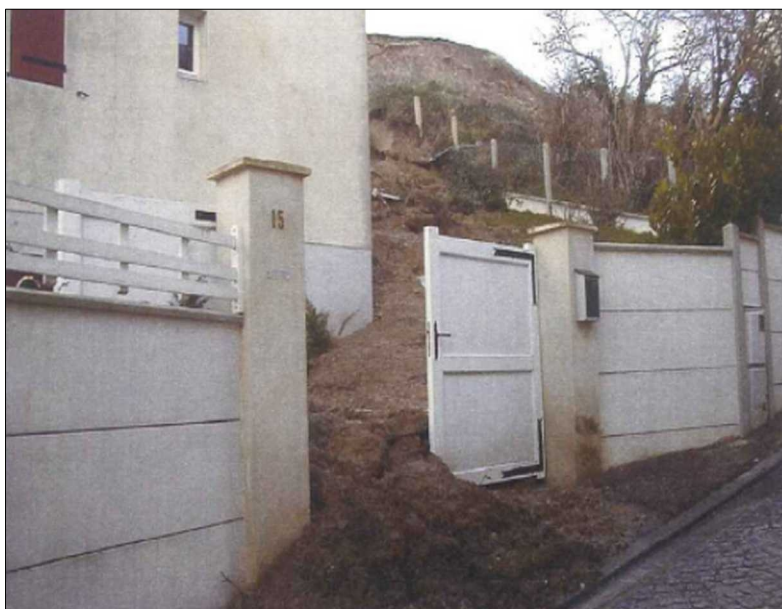
Figure 10: propagation du glissement de terrain de 1999 jusqu'à la rue Torteron.
