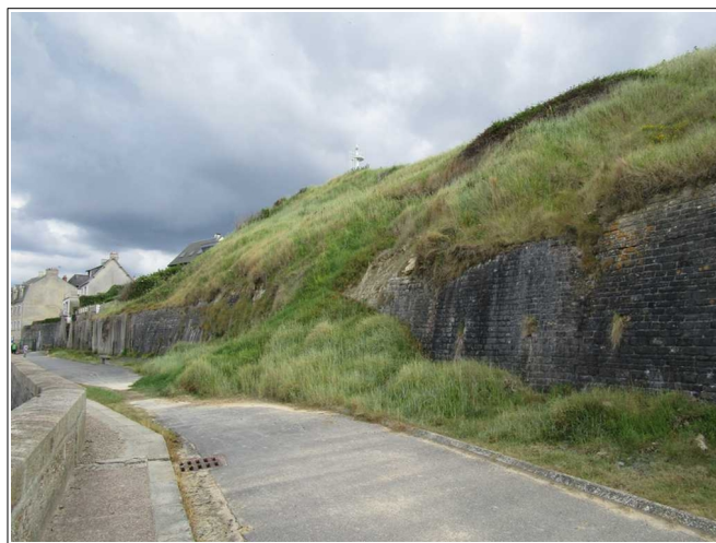
Figure 34: chemin des Tourettes atteint par un glissement de terrain.
