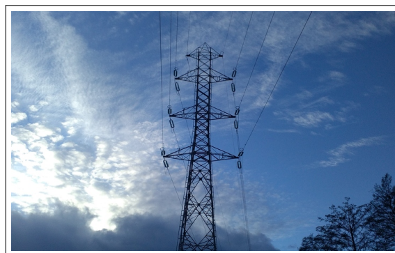
FIGURE 9 – Vue des conducteurs, support 7
