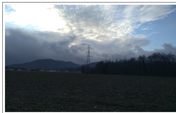
FIGURE 4 – Vue des conducteurs de la/des liaison(s) côté support 7
