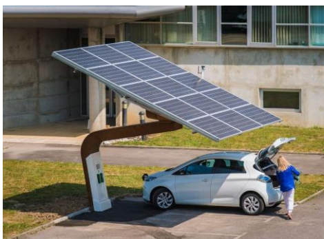
Borne de recharge électrique
