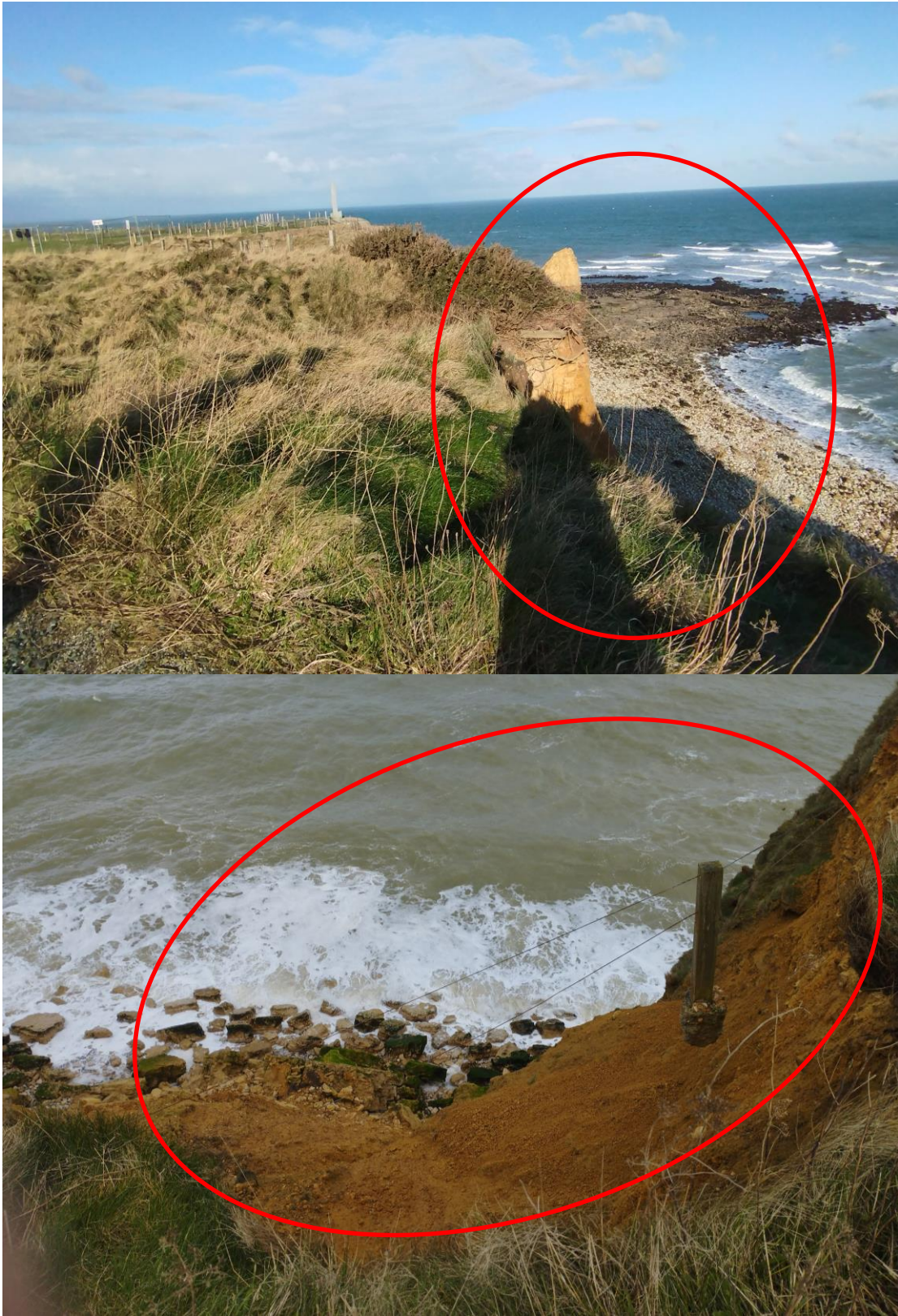
Photographie 3 : Glissements de terrains de la falaise observés sur le site – (Crédit photo : SOCOTEC - 2025)
