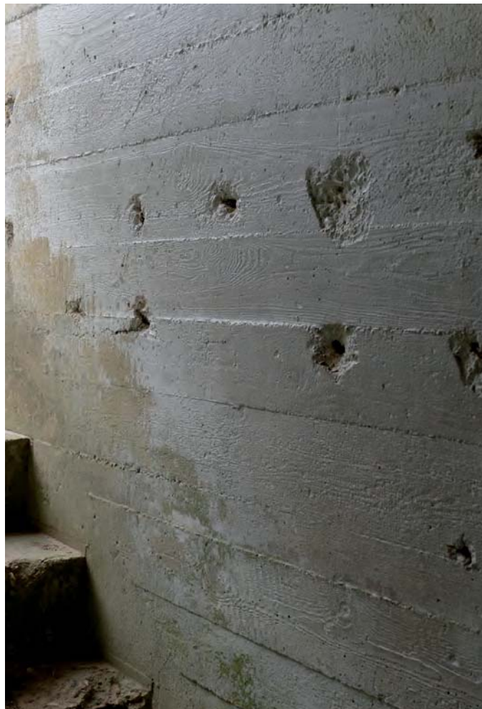
Fig. 36 Ouvrage bétonné n°14, mur avec traces de coffrage en planches et impacts de balles. © Vincent Carpentier/Inrap 2019
