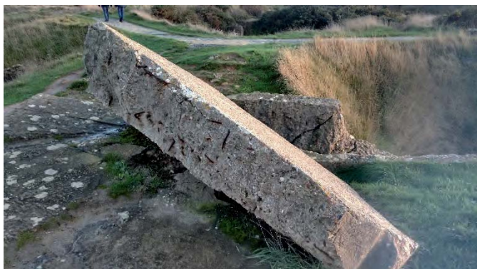
Figure 25 : Point de vue n°19, morceau de béton armé, zone de saturation et d'obstacle.
