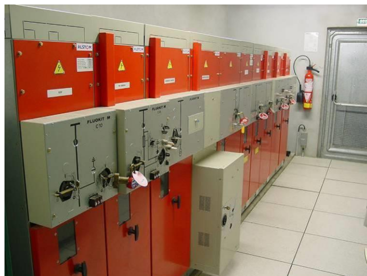
Illustration 11 : Intérieur d'un poste de livraison
