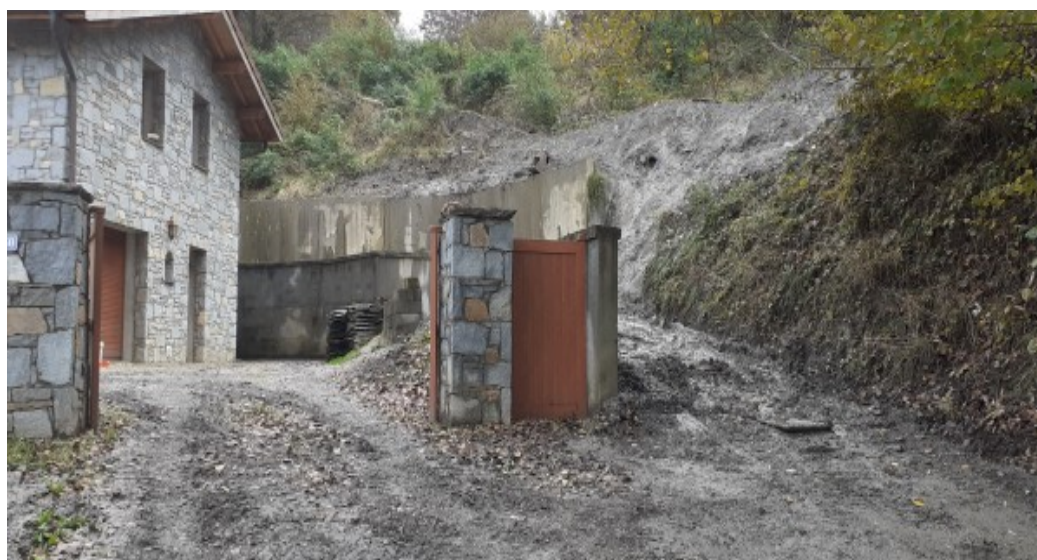
Figure III.32: Versant le long de la RD94, sous le hameau de l'Epigny. Combe humide, les terrains altérés glissent régulièrement. Coulée boueuse possible.
