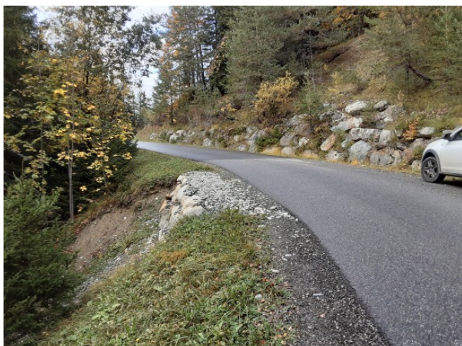
Figure III.30: RD92, glissement en aval de la chaussée confortée par des enrochements, amont du ruisseau des Côtes.
