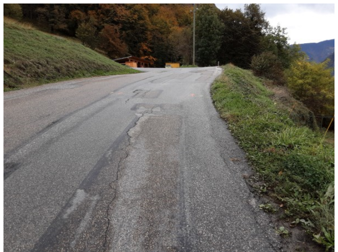
Figure III.25: Chaussée fissurée et déformée (RD92) à Villoudry.
