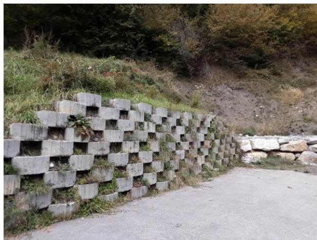
Figure III.29: Hameau Le Crozet, ouvrage de confortement du talus. Plus haut, lieu d'un ancien glissement ayant fait l'objet de drainage.
