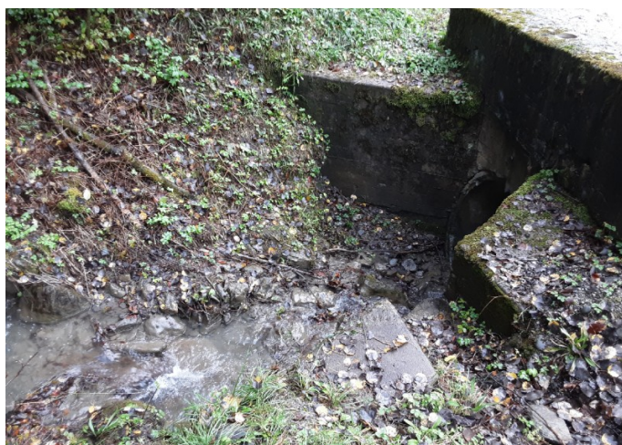
Figure III.14: Busage d'un des filets du ruisseau de Villargerel sous la RD92, à proximité du hameau de la Crozet. Embâcle et obstruction possible.
