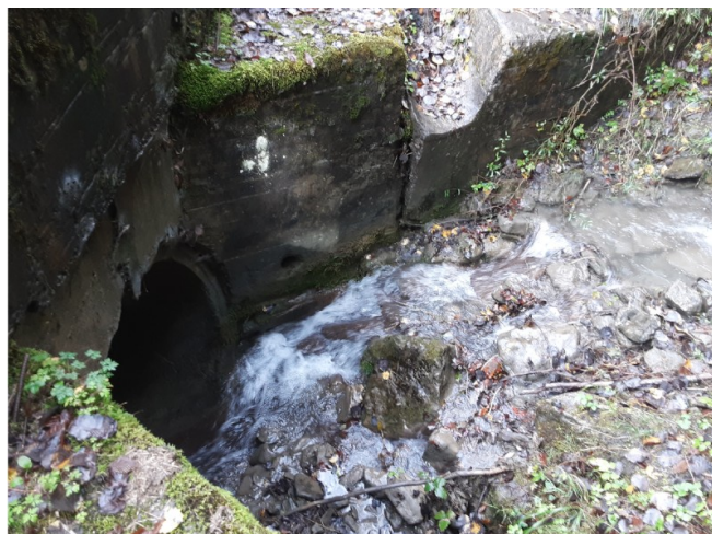
Figure III.15: Busage d'un autre linéaire du ruisseau de Villargerel sous la RD92, à proximité du hameau de la Crozet. Embâcle et obstruction possible.
