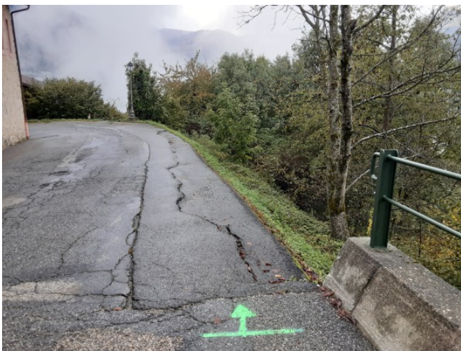
Figure III.24: Chaussée en bordure de combe à Villargerel, près de l'Église (RD92). Déformations de la chaussée importantes.
