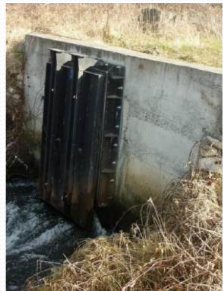
Sortie de la station d'épuration
