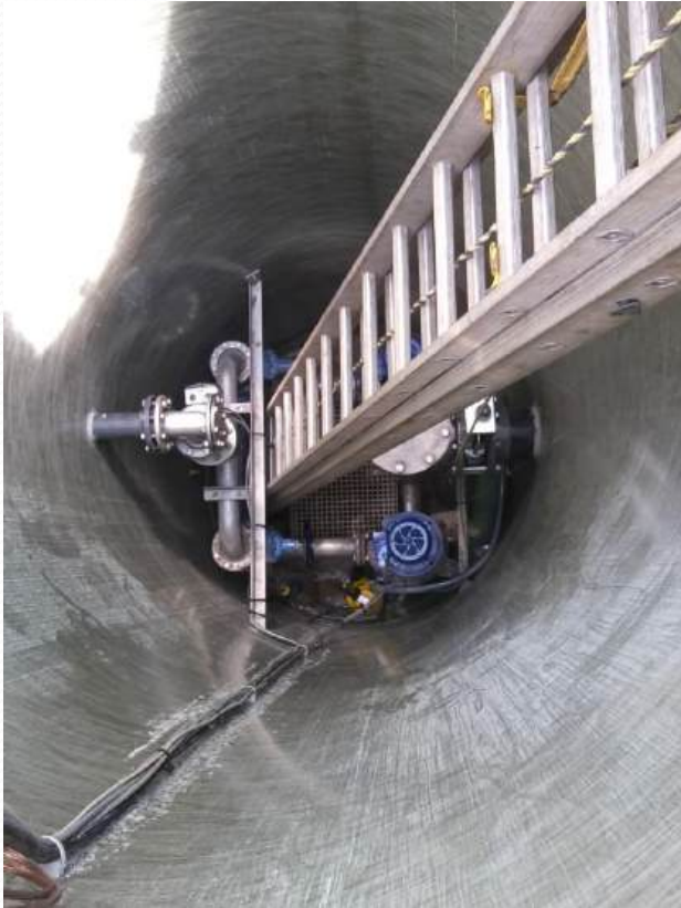
Intérieur poste du secteur Prévoriaux
