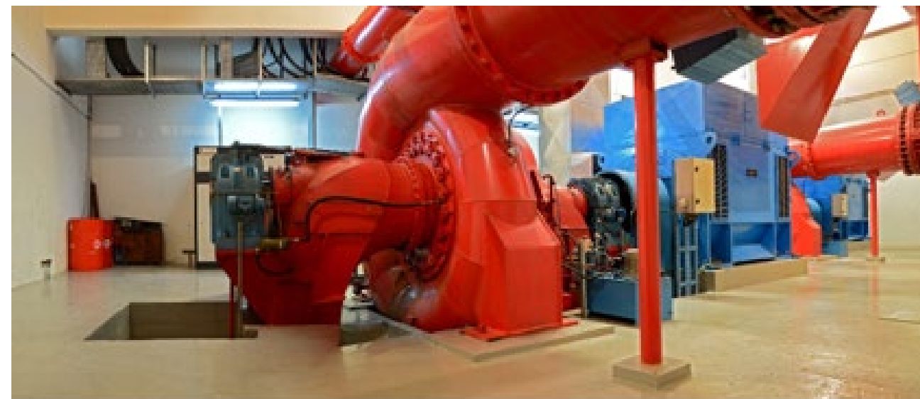
Figure 10 : Illustration de turbines de centrale hydroélectrique
