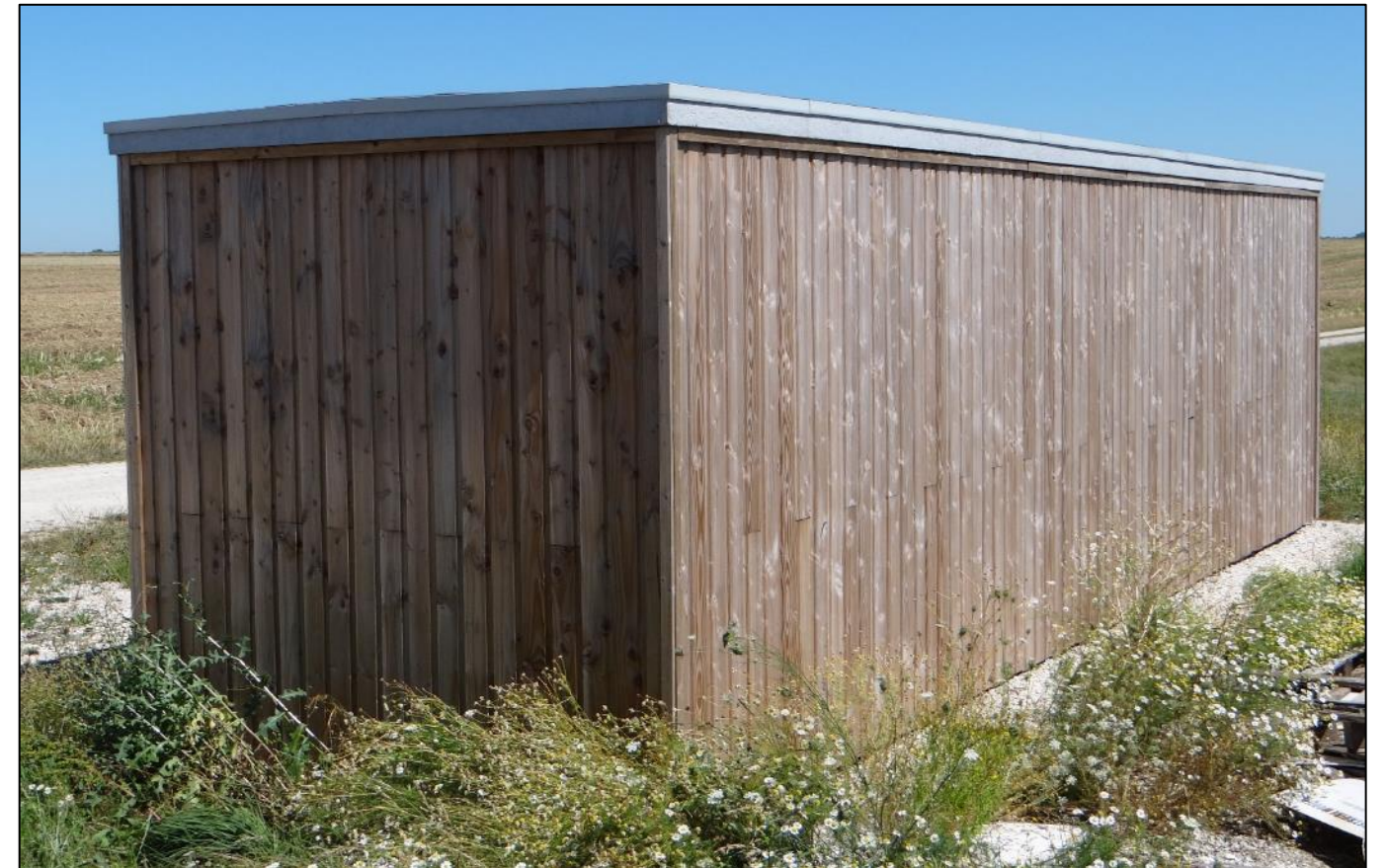
Photo 9 : Référence d'un bardage bois vertical pour un poste de livraison (Source : BE Jacquelin et Chatillon)
