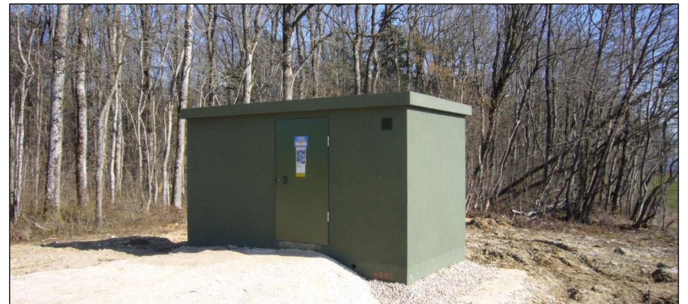
Photo 10 : Référence d'un enduit vert feuillage pour un poste de livraison (Source : BE Jacquelin et Chatillon)
