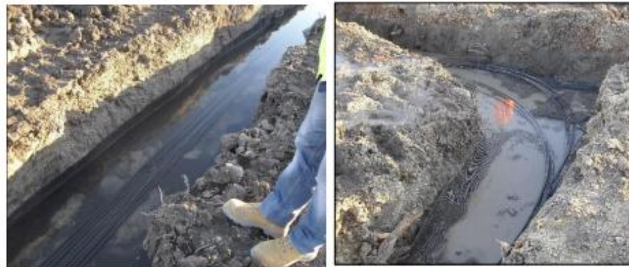
Exemples de passages de câbles reposant sur un grillage à maille fine
