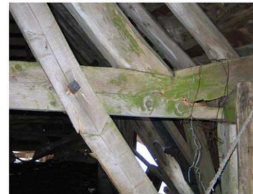
Extrémités de poutre en appui sur un mur. (une surcharge mécanique ou l'humidité risque de fragiliser ce point faible)
