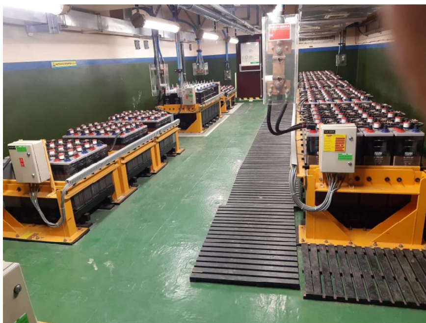
Figure 8. Photo des locaux contenant les batteries
