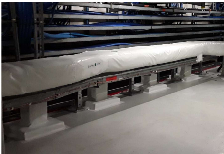
Figure 6. Exemple de protection de chemin de câble
