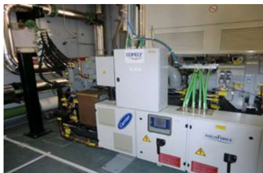
Nouveau groupe froid (+ 50% de capacité frigorifique)
