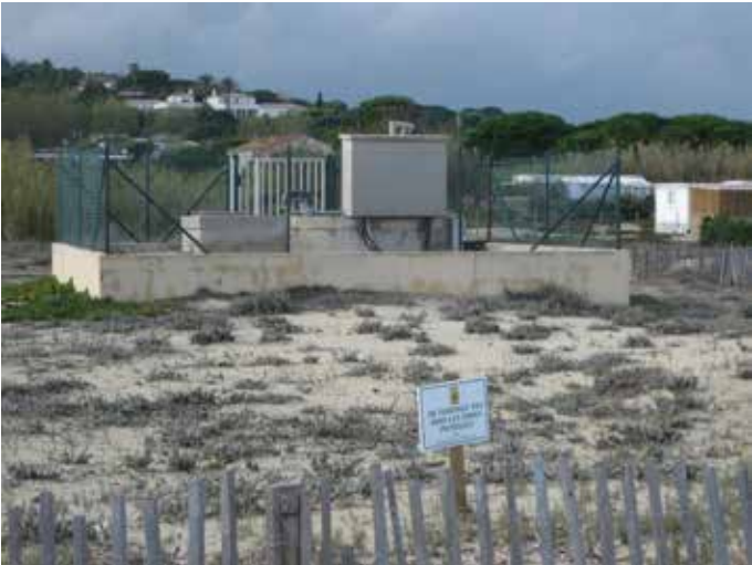
Fig 103 : Station de refoulement de Patch dans la zone protégée du cordon dunaire
