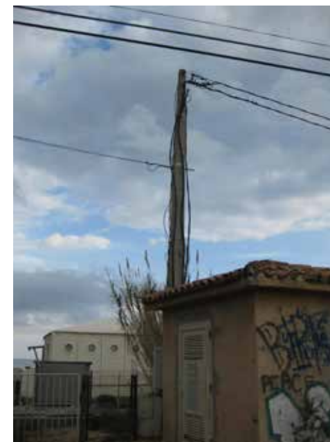
Fig 115 : Départs basse tension depuis poste transformateur du secteur de Tamaris
