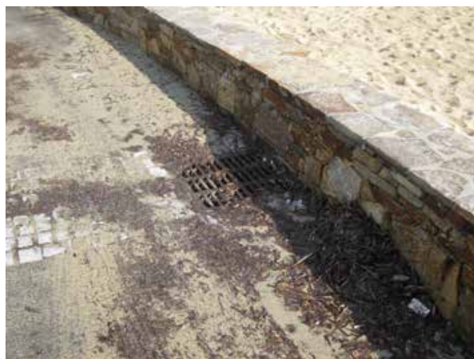
Fig 113 : Grille d'évacuation des eaux pluviales en aval du boulevard Patch – colmatage complet de l'ouvrage
