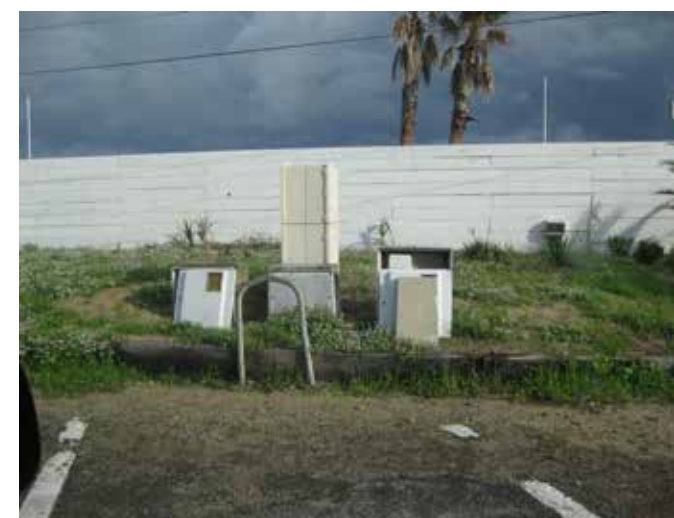
Fig 116 : Coffrets sur le parking du secteur Patch
