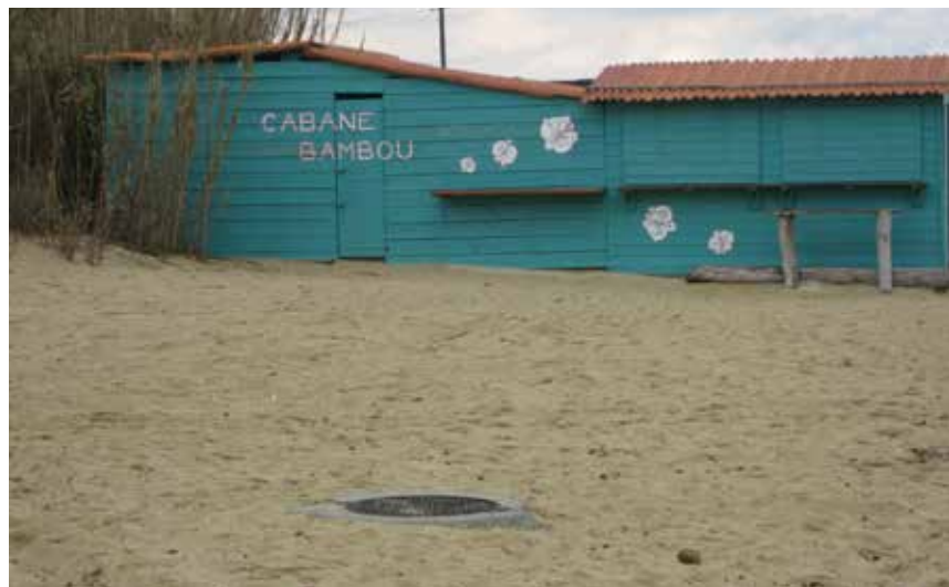
Fig 104 : Tampon de regard du réseau gravitaire implanté sur la plage dans le secteur de Bonne Terrasse
