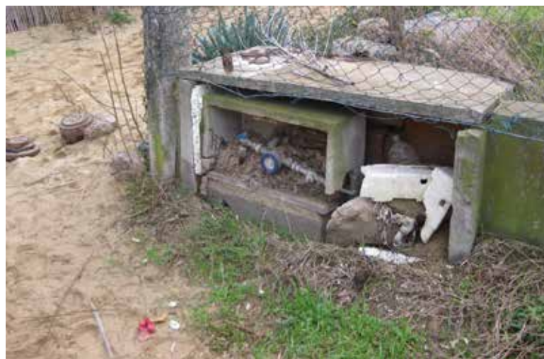
Fig 106 : Coffret pour branchement riverain aux abords de la Voile Rouge
