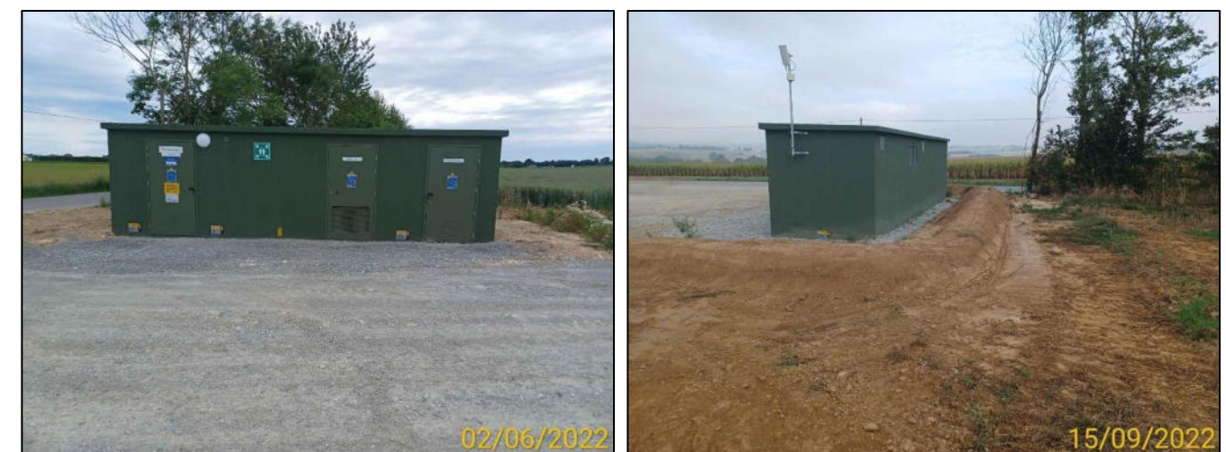
Figure 23 : Exemples de vues extérieures d'un poste de livraison (Source : Energiequelle)
