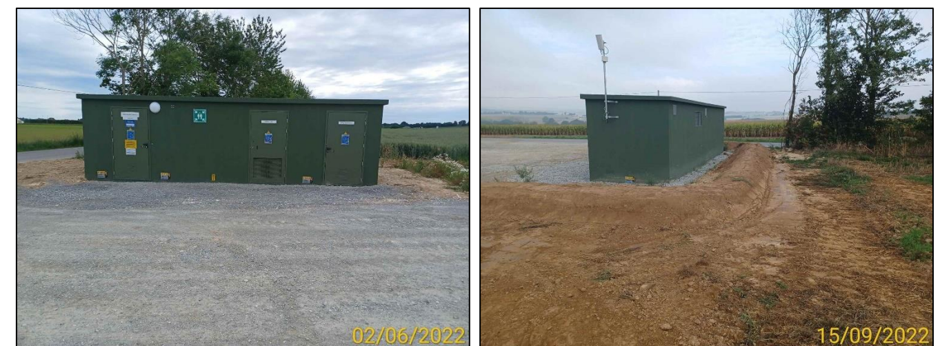
Figure 11 : Exemples de vues extérieures d'un poste de livraison (Source : Energiequelle)
